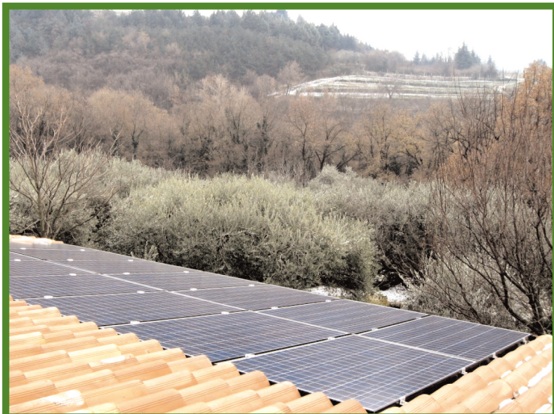
Un tetto ricoperto da pannelli fotovoltaici, facenti parte di quel mix energetico richiesto alla nuova generazione per risparmiare sui costi del futuro
